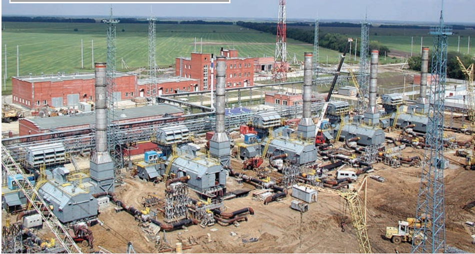
Компрессорная станция «Ставропольская» на газопроводе «Голубой поток», 2003 г.
